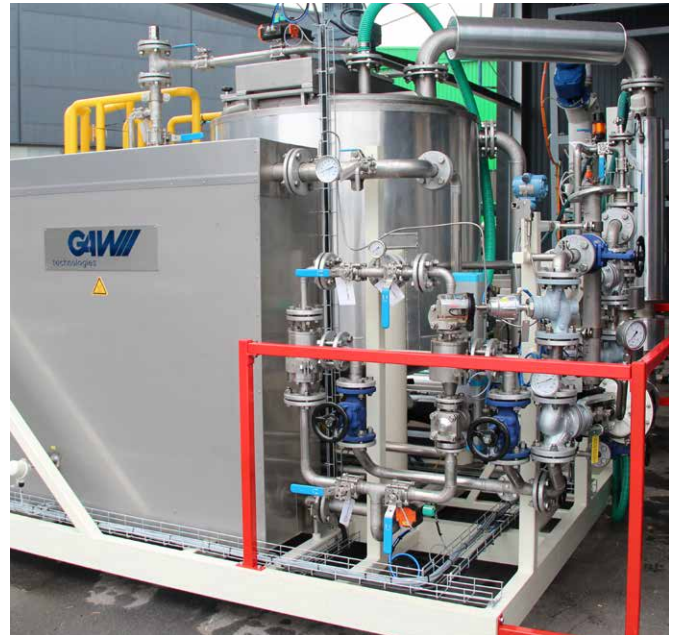
Abwasserfrei ist unsere Stärke.
